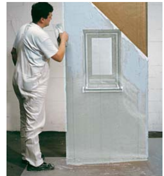
2. Armovací tkanina INTHERMO HFD je ukládána plošně.
